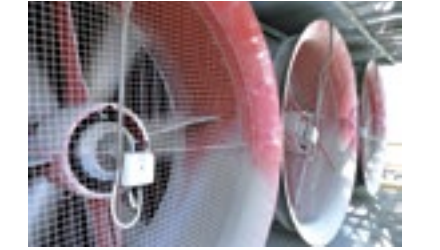
Çimento Fabrikası Eşanjör Soğutma Fanları 80.000 m 3 h - 10 mmSS
