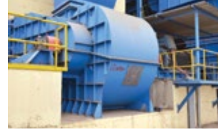
Demir Çelik Fabrikası 530.000 m 3 h - 450 mmSS
