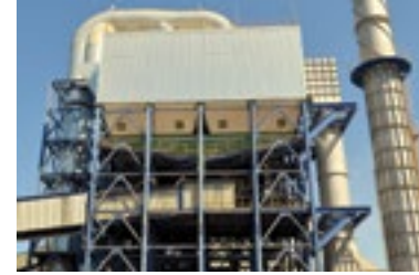
Çimento Fab. Çimento Değirmeni Filtre Fan 381.400 m 3 /h - 306 mmSS
