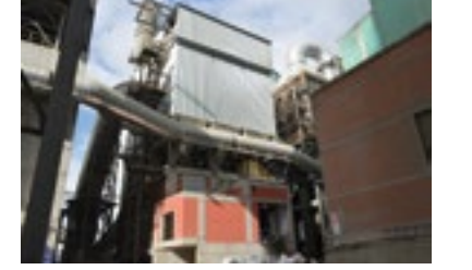
Çimento Fabrikası Klinker Soğutma Filtre Fanı 505.200 m 3 /h - 450 mmSS
