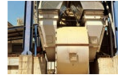
Çimento Fabrikası Klinker Soğutma ESP Fanı 704.939 m 3 h - 255 mmSS
