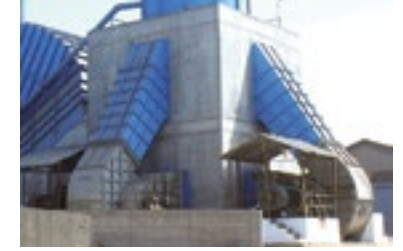
Demir Çelik Fabrikası 480.000 m 3 h - 450 mmSS (3 ADET)
