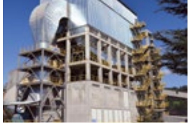
Çimento Fab. Çimento Değirmeni Sistem Fanı 610.000 m 3 /h - 705 mmSS
