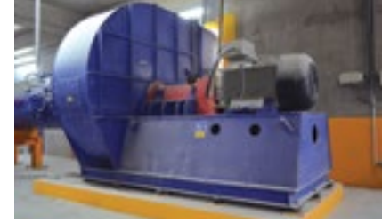
Gübre Fabrikası 53.000 m 3 h - 550 mmSS
