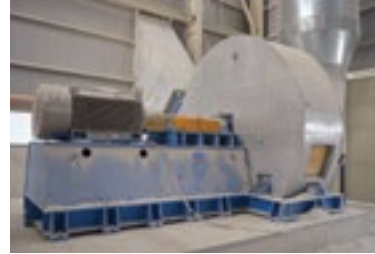
Gübre Fabrikası 110.000 m 3 h - 850 mmSS
