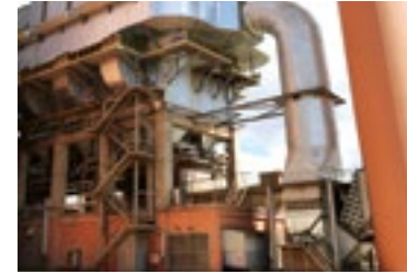
Çimento Fabrikası Farın Fırın Filtre Fanı 700.000 m 3 h - 4-450 mmSS
