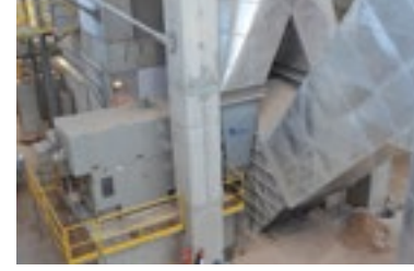
Çimento Fab. Farin Değirmeni Sistem Fanı 675.000 m 3 /h - 965 mmSS
