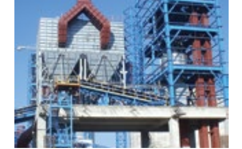
Çimento Değirmeni Torbalı Filtresi 170.000 m 3 /h
