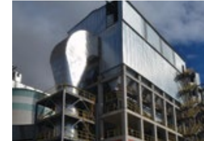
Çimento Değirmeni Torbalı Filtresi 610.000 m 3 /h
