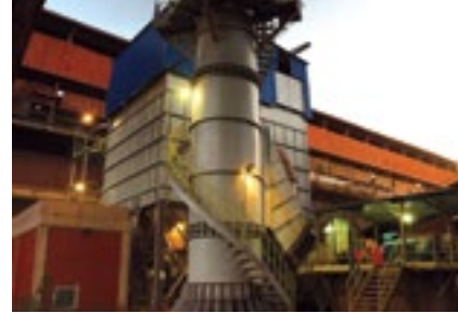
Demir ve Çelik Fabrikası Sinter Cevher Hazırlama Tesisi Torbalı Filtresi 300.000 m 3 /h
