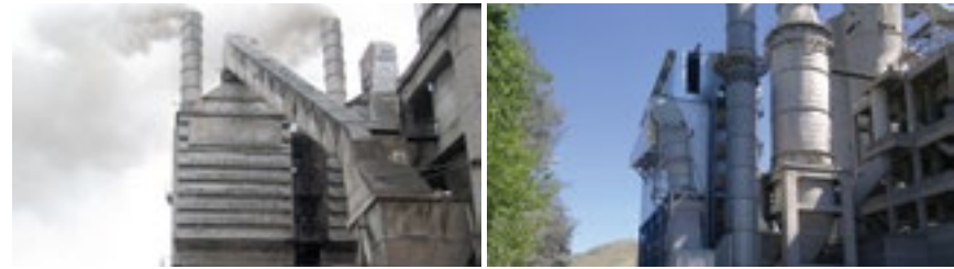
Çimento Farin Fırın ESP Dönüşüm 425.000 m 3 /h
