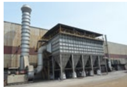
Döküm Fabrikası Torbalı Filtresi 150.000 m 3 /h
