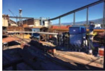
Demir ve Çelik Fabrikası Kükürt Giderme Tesisi Torbalı Filtresi 220.000 m 3 /h
