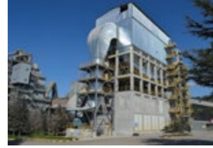
Çimento Değirmeni Torbalı Filtresi 610.000 m 3 /h
