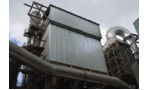
Çimento Klinker Soğutma Torbalı Filtresi ve Soğutma Eşanjörü 455.370 m 3 /h
