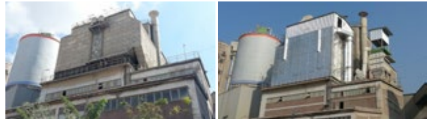
Çimento Değirmeni ESP Dönüşüm 90.000 m 3 /h
