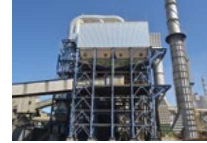
Çimento Değirmeni Torbalı Filtresi 150.000 m 3 /h
