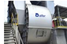
Цементный Завод – Вентилятор (Внешнее Статическое Давление) 1.057.373 м 3 /ч – 305 mm WC
