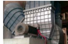
Цементный Завод Вентилятор Для Цементного Процесса 1.152.373 м 3 /ч – 400 mm WC
