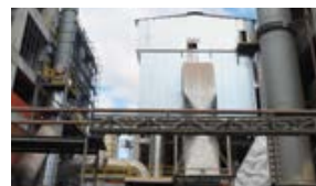
Цементный Завод – Вентилятор Для Клинкерного Фильтра 750.000 м 3 /ч – 480 mm WC
