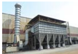
Литейный Завод 150.000 м 3 /ч – 550 mm WC
