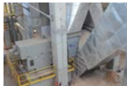
Цементный Завод – Система Сырьевой Мельницы 675.000 м 3 /ч – 965 mm WC
