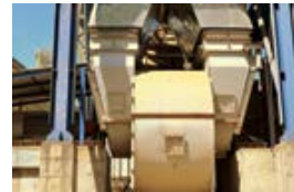
Цементный Завод – Вентилятор Охлаждения Клинкера (Внешнее Статическое Давление) 704.939 м 3 /ч– 255 mm WC
