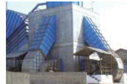
Металлургический Завод 480.000 м 3 /ч – 450 mm WC
