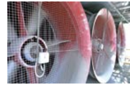
Цементный Завод – Охлаждающий Вентилятор Для Теплообменника 80.000 м 3 /ч – 10 mm WC
