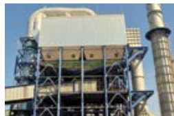
Цементный Завод – Вентилятор Цементной Мельницы 381.400 м 3 /ч – 306 mm WC
