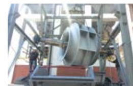
Цементный Завод – Вентилятор Фильтра Мельницы 520.000 м 3 /ч – 340 mm WC
