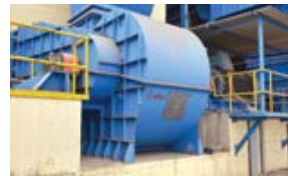
Металлургический Завод 530.000 м 3 /ч – 450 mm WC
