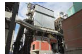
Цементный Завод – Вентилятор Фильтра Для Охлажденного Клинкера 502.200 м 3 /ч – 450 mm WC
